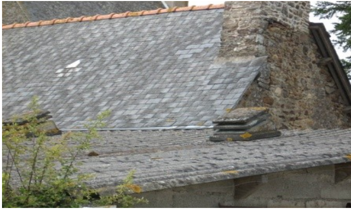
Couverture en matériaux contenant de l'amiante
